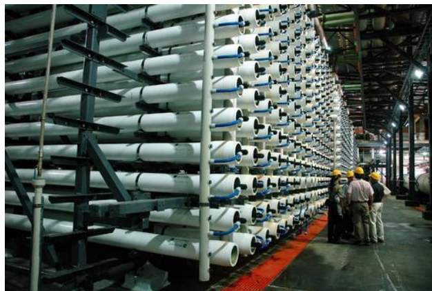
Grootschalige omgekeerde osmose installatie voor de productie van drinkwater.
