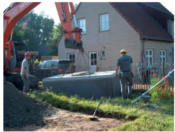
Een regenwatertank bij een nieuwbouwhuis.
