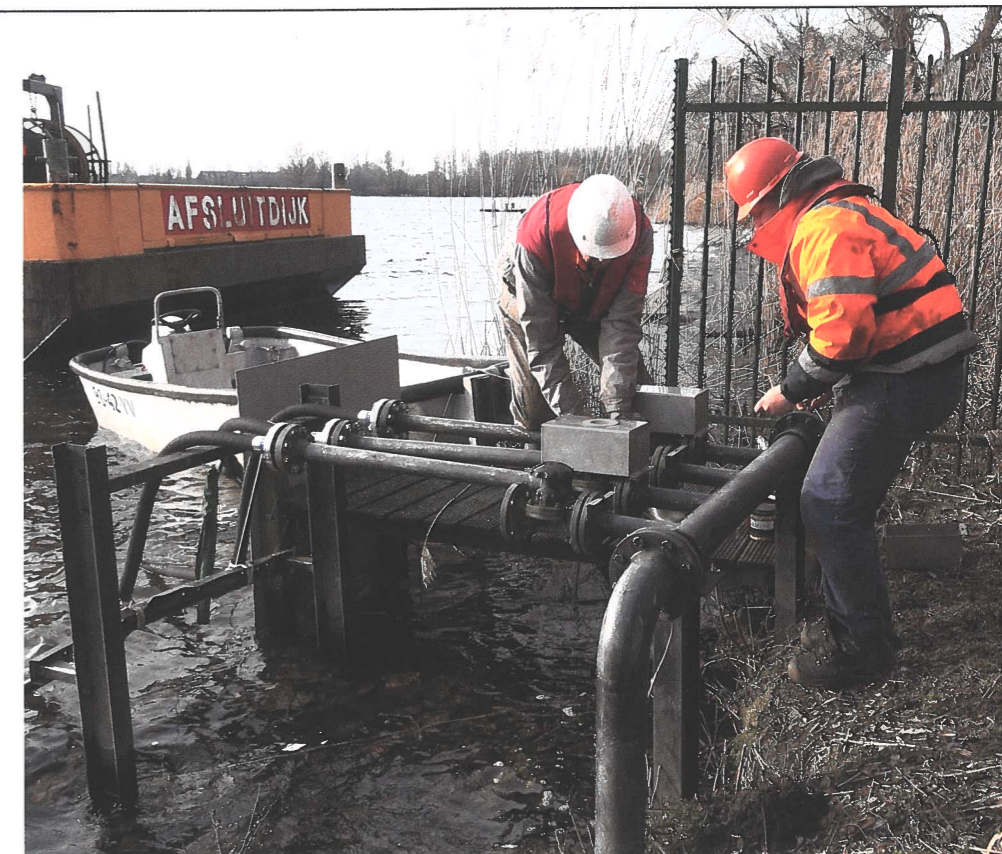
Op de bodem van de Nieuwe Meer in Amsterdam heeft het Hoogheemraadschap van Rijnland een luchtmenginstallatie aangelegd. Grote compressoren blazen lucht in een netwerk van leidingen, waardoor bellen ontstaan die het water in beweging brengen. Door het bewegende water zouden blauwalgen geen kans moeten krijgen om te groeien (foto: Rijnland).
